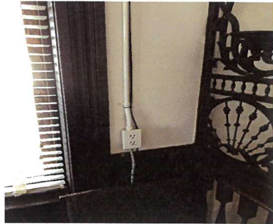
4.14. EXPOSED ELECTRICAL CONDUIT
